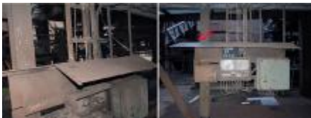
Ergänzter Schutzdachbestand aus dem Jahr 2011 - links der Vorzustand, rechts nach der Restaurierung (<--). Die Ergänzung wurde mit verzinktem Stahlblech ausgeführt und an der vorhandenen Tragkonstruktion befestigt.
