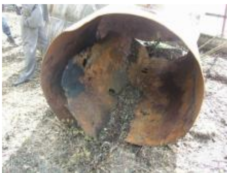
Kokerei Zollverein: Rückbau, Reparatur oder Rekonstruktion? Die Schadstoffbelastung führte zu schweren Schäden an der Substanz bis zu einem Totalverlust der Rohrleitungswandung. Bildurheberrechte: Büro für Restaurierungsberatung Götz | Lindlar 2007
