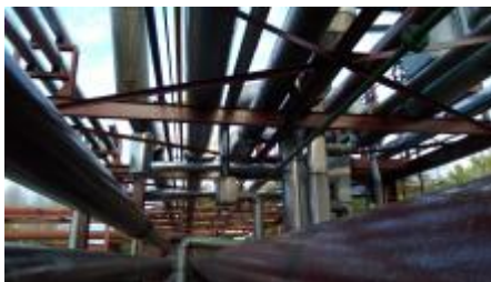
Kokerei Zollverein, Rohrleitungstrasse Kammgebäude: Ziel „Erhaltung Ist-Zustand“ Bildurheberrechte: Büro für Restaurierungsberatung Götz | Lindlar 2011
