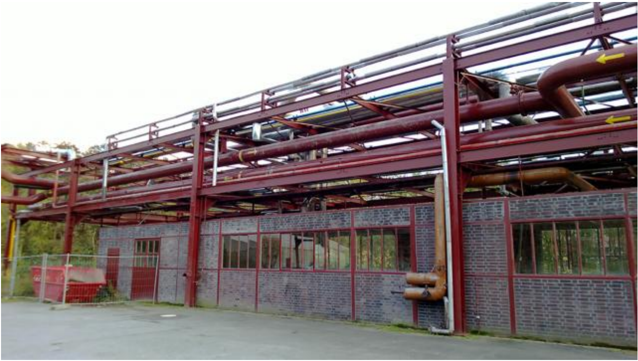
Rohrleitungstrasse Kammgebäude (Aufnahme 2013)
