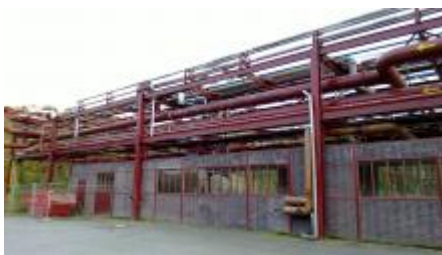
Rohrleitungstrasse Kammgebäude (Aufnahme 2013) Bildurheberrechte: Kornelius Götz
