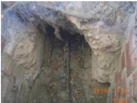
Gefährliche Zustandserfassung Bildurheberrechte: Ulrich Stappert
