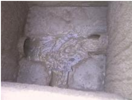
Verfestigte Ablagerungen in einem Schacht Bildurheberrechte: Ulrich Stappert
