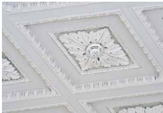
Integrierter Rauchmelder (Detaillansicht)
