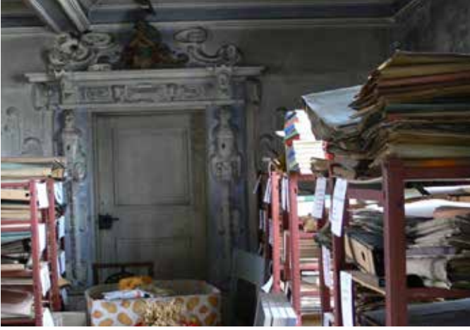
Brandlasten und verstellter Ausgang als Gefahrenquelle
