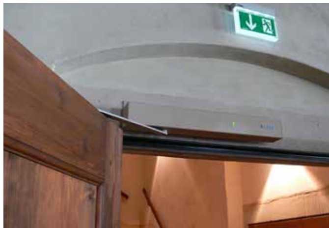
Obertürschließer in Bestandstür
