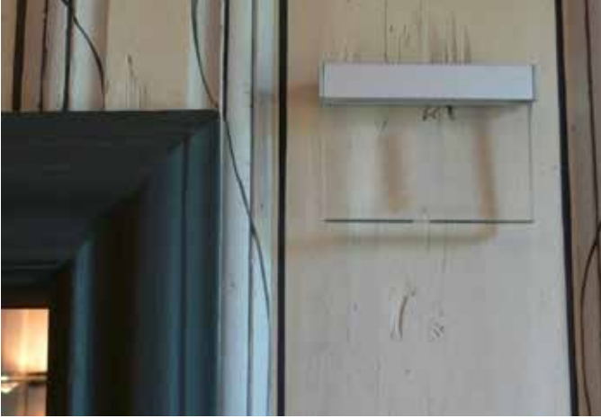
Nur im Brandfall leuchtendes Rettungszeichen
