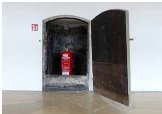
Nutzung einer Kaminanlage zur Unterbringung eines Handfeuerlöschers
