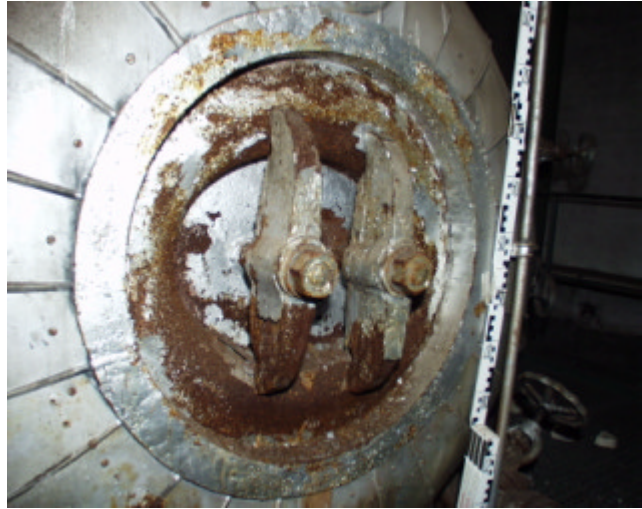
2 Stark korrodierte Oberfläche am Kessel von 1956
