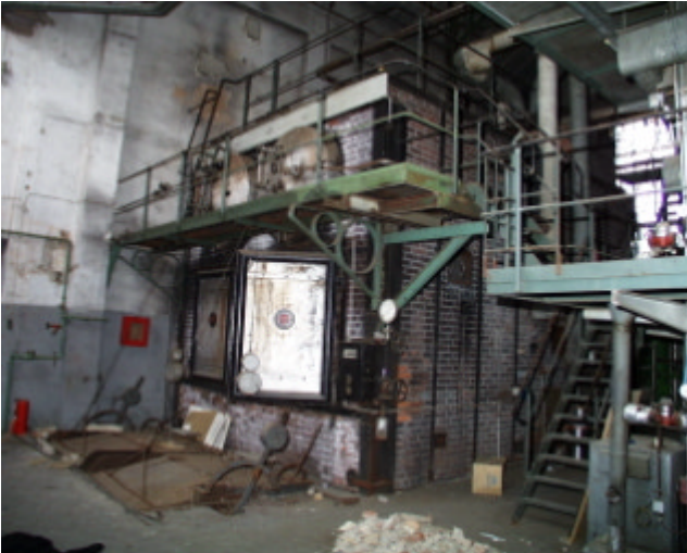
1 Kessel Maschinenfabrik Esslingen, Baujahr 1922
